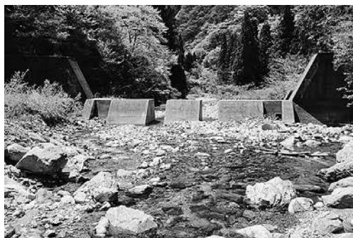
写真10 2006年にスリット化された堰堤
